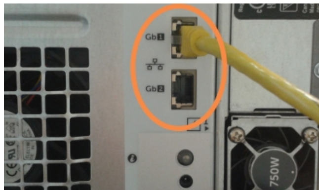
Cyret 16-5: Θύρες Ethernet που χρησιμοποιούνται για το σύστημα BOND RemoteCare
